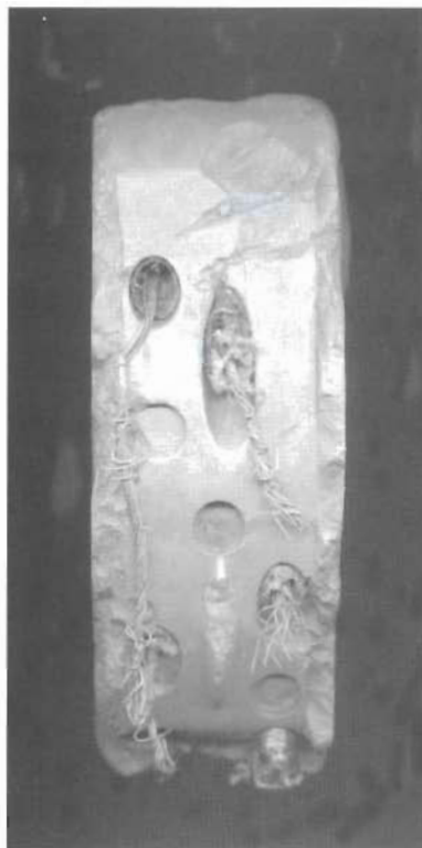
Caja conexiones encendido
